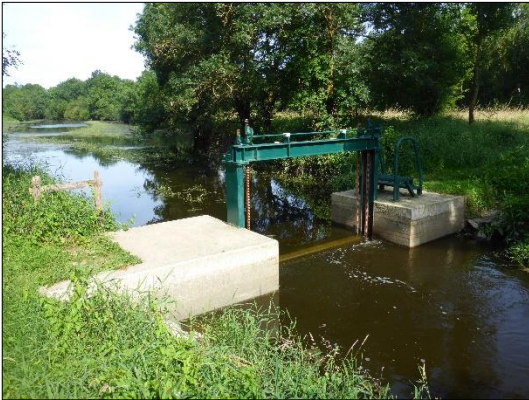
Figure 154 : Vannage de régulation hydraulique de la boire (21/06/2018).
