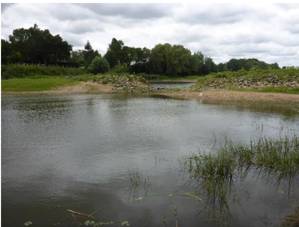
Figure 222 : Extrémité aval du site (15/07/2020) – Brèche dans l'épi.
